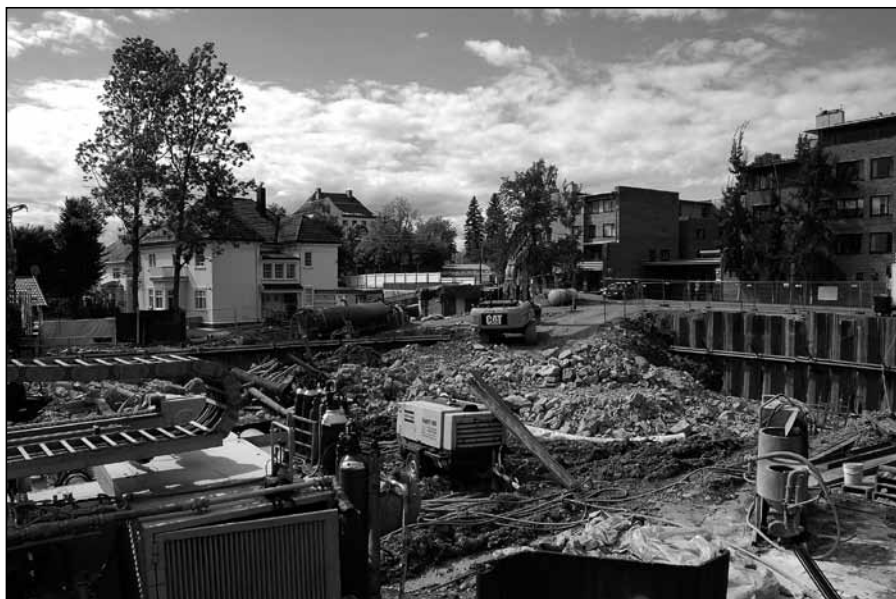
Byggeplassen på Slemdalsveien 70 12. august 2011. Til venstre viser en plakat det ferdige resultat – Vinderenborgen. Begge foto: Finn Holden.
